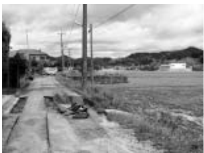
島田川の越水により道路が陥没
