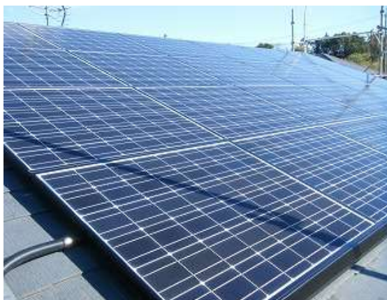
太陽光発電設備
