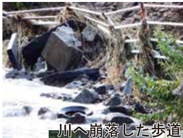
陥没した歩道
