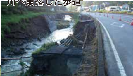
川へ崩落した歩道
