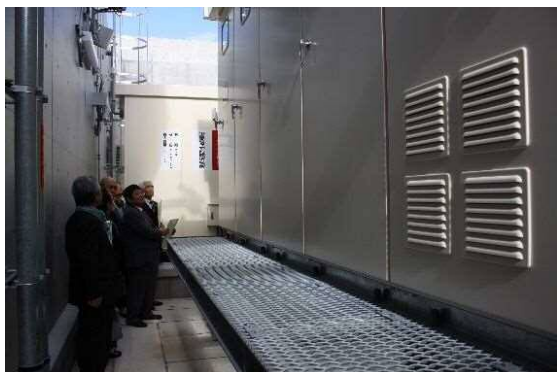
非常用発電機
