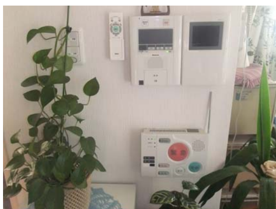
各住居に設置されている安全対策機器
