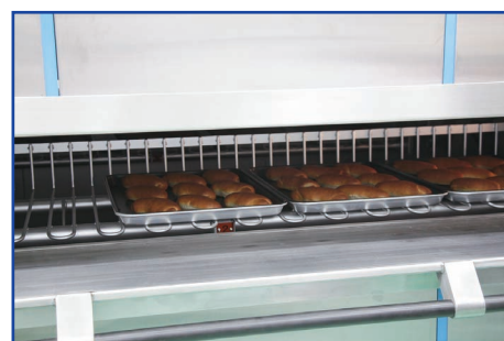
製パン室（オーブン内部）
