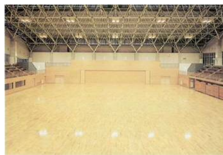
総合体育館空調設備更新
