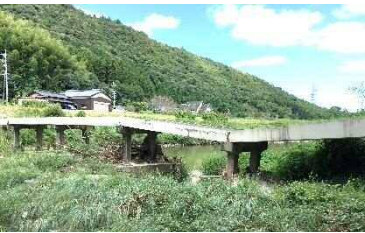
現在も通行止めの小野橋
